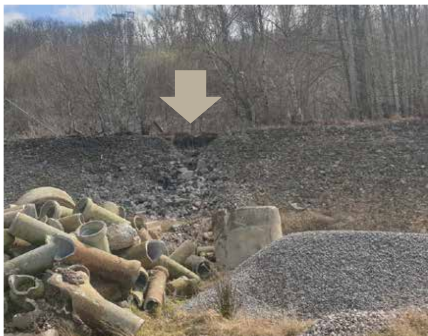
Bildtext: Visar den plats på banvallen där man ser att gruset sköljts bort där trumman har gått sönder (efter åverkan i samband med att Trafikverket anlade en tillfartsväg)
